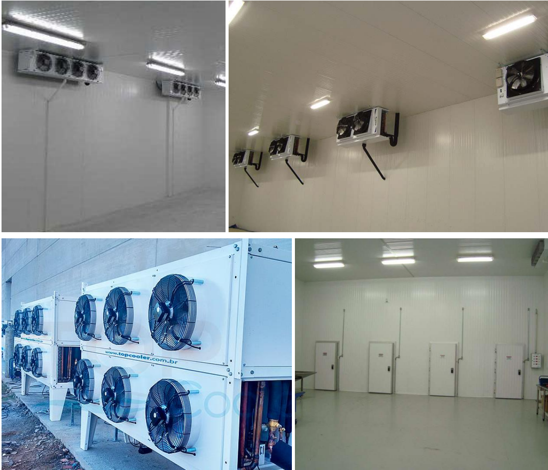
Figura 3 - Exemplos de câmaras frias e a disposição de seus equipamentos.
