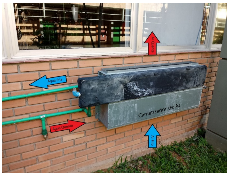
FIGURA 11 - Climatizador de ar instalado para a realização do experimento.
