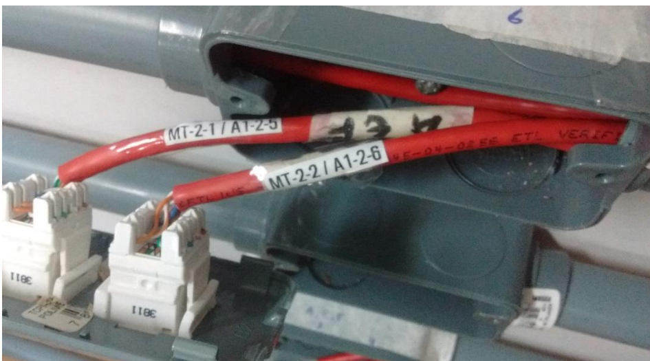
Foto de um dos MUTO utilizados mostrando a identificação de cada cabo.
