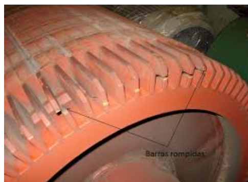
Figura 2 – Barra quebrada no rotor
